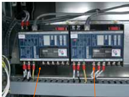
照明制御ユニット
